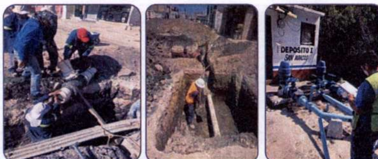
Personal de APAST en la construcción de red de agua potable en comunidades de Tultitlán y mantenimiento de Tanques de Bombeo.
