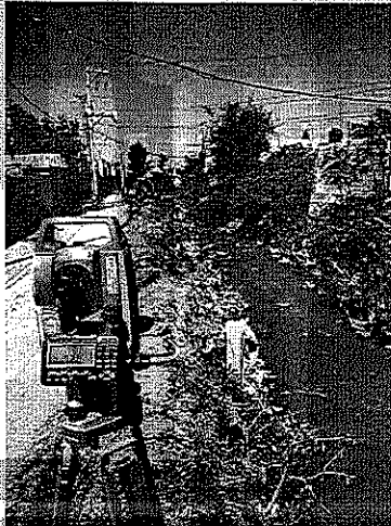
Trabajos de Ingeniería civil e hidráulica en canal "Las Cruces", colonia La Libertad, zona Sur
