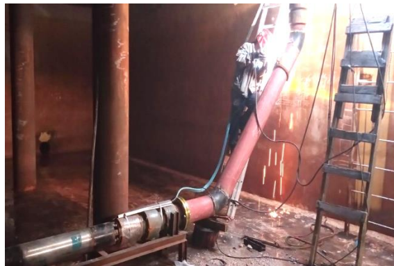
Acoplamiento de equipo de bombeo Tanque San Marcos, zona Sur
